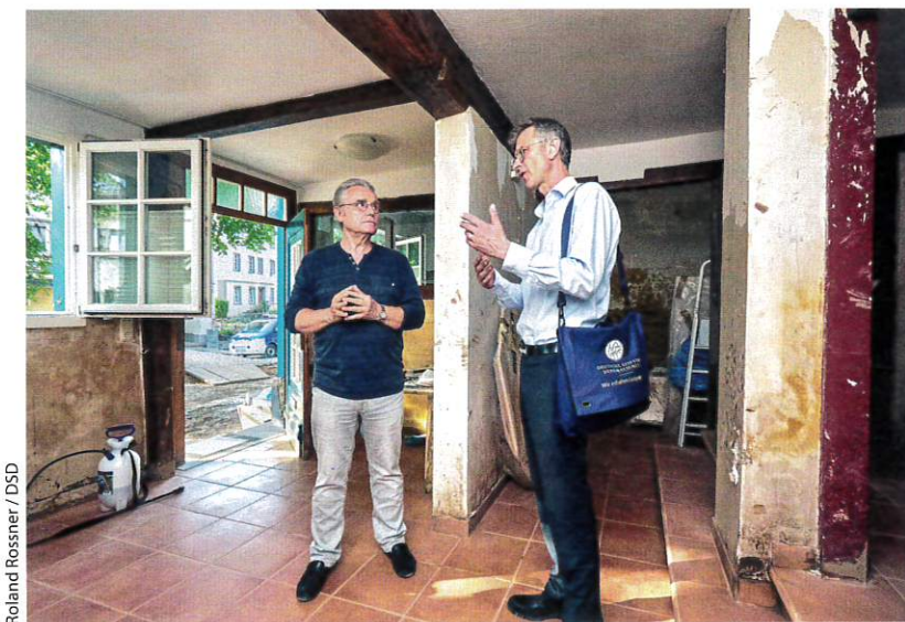
▲ Ortstermin in Bad Münstereifel: DSD-Vorstand Dr. Steffen Skudelny erläutert Rolf Keshage (l.), wie ihm durch die Hochwasser-Nothilfe der DSD bei dem beschädigten Fachwerkhaus aus dem 17. Jahrhundert geholfen werden kann.
